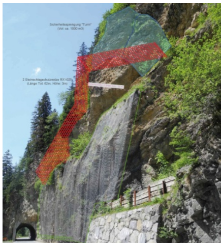
Tunnel Schleif – Schutzmassnahmen nötig
