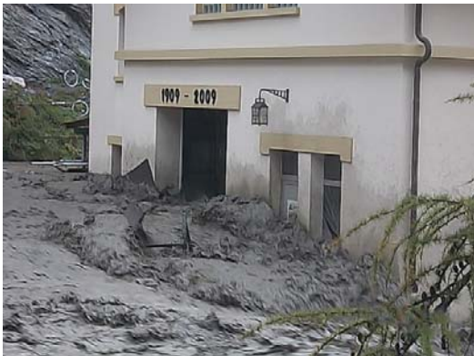
Die Wasser-Schlamm-Massen strömten frontal beim Gebäude ein ...
